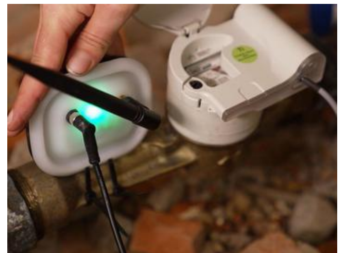
Le projet Easy Conso est un service de comptage intelligent destiné à traquer les gaspillages d'eau. © D.R.
