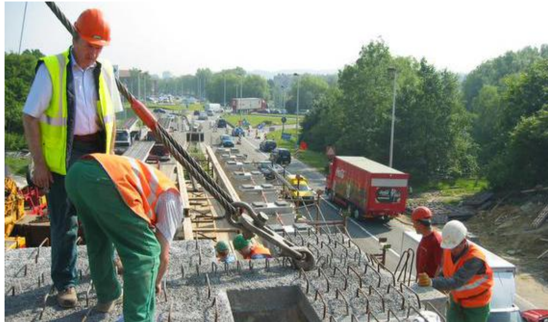
« Je vais sur le chantier et je vérifie la qualité du travail réalisé. Il peut s'agir d'une rénovation d'un pont, d'infrastructures, de la mise en place d'une passerelle inter-rail, de la réhabilitation d'un ancien tunnel de tram, etc. »
