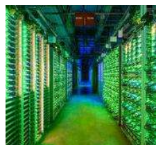
La salle des serveurs. ► D.R.
